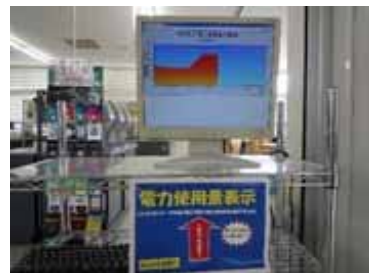
ラウンジに設置してある デマンド監視モニタ
